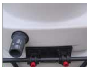
VALVE DE DÉBIT D'EAU
