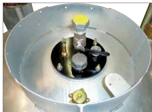
Vu du dessus, cuve sans pompe
