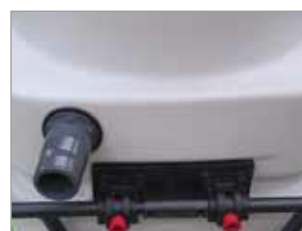
VALVE DE DÉBIT D'EAU
